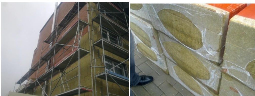
18.attēls. Ēkas siltumizolācijas darbu veikšana bez aizsargplēves un izolācijas materiāla pakļaušana mitrumam
